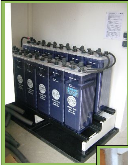
Batterie-Anlage 1000 Ah, 24 V
