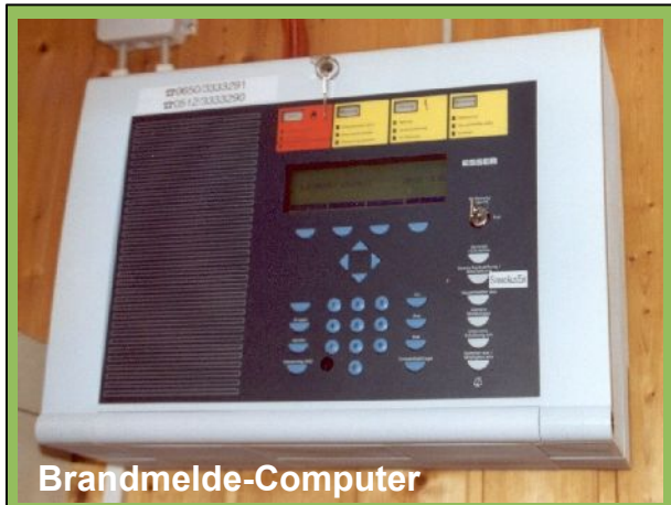
Rauchmelder im Tagesraum
