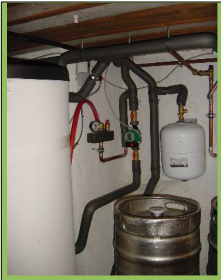
400-Liter-Boiler mit Rohrinstallation
